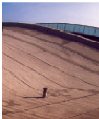
9. Alacsony lágyuláspontú ragasztóval rögzített hőszigetelő táblák: a szigetelés felületén esésirányú ráncok
